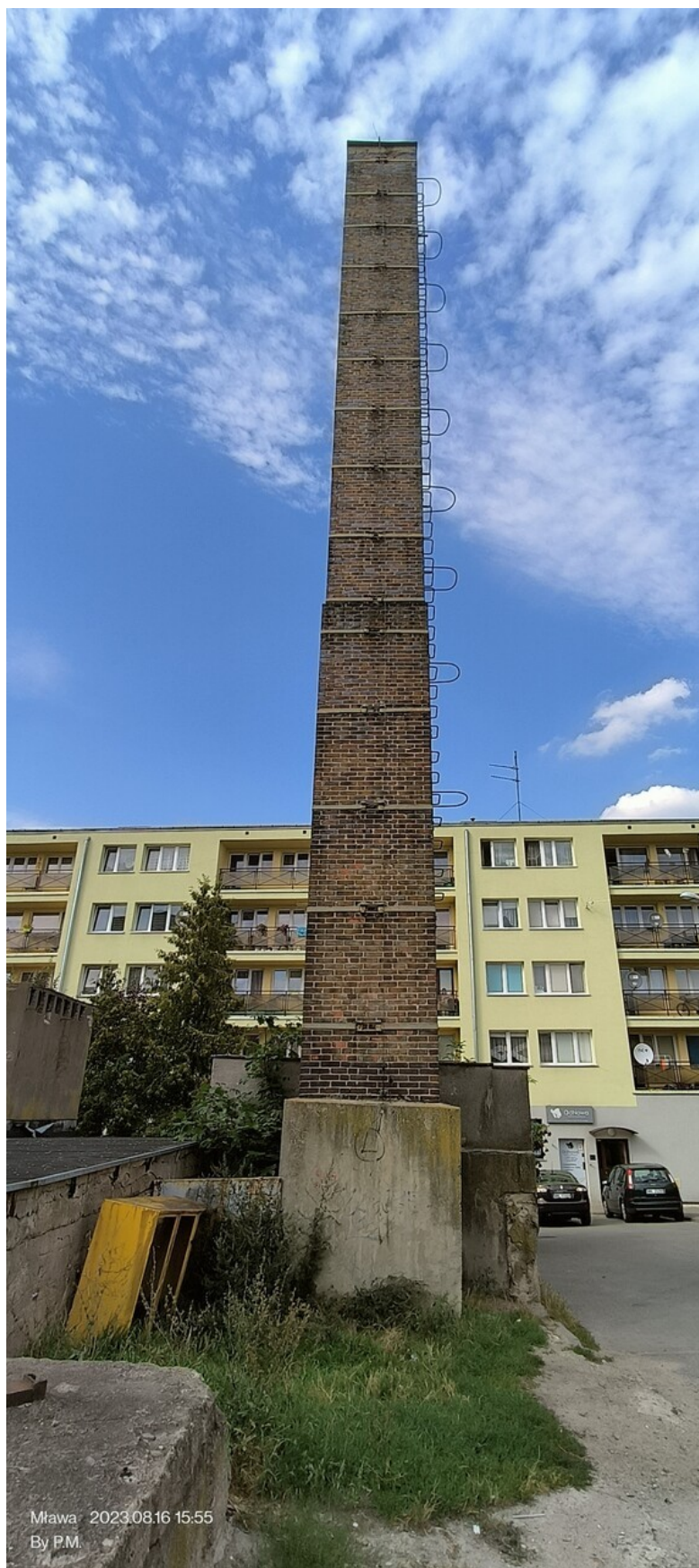
Widok od strony południowej; przy kominie widoczne budynki nieprzeznaczone do rozbiórki - po lewy budynek kotłowni, na wprost budynek usługowy.
