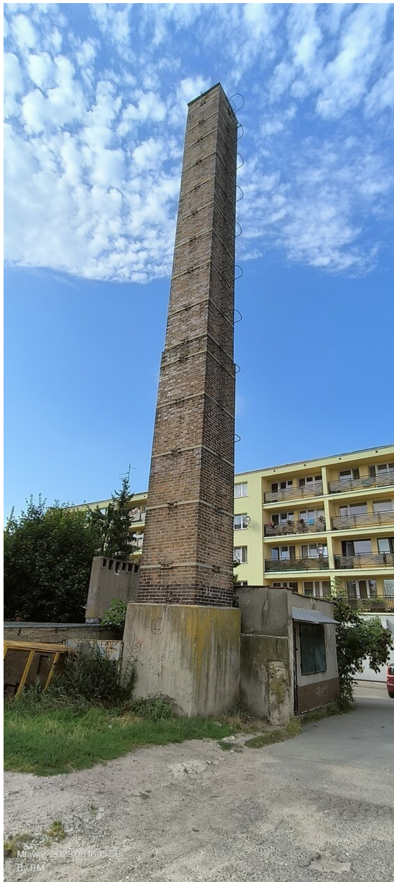
Widok od strony południowo-wschodniej; przy kominie widoczne budynki nieprzeznaczone do rozbiórki - po lewej budynek kotłowni, po prawej budynek usługowy.
