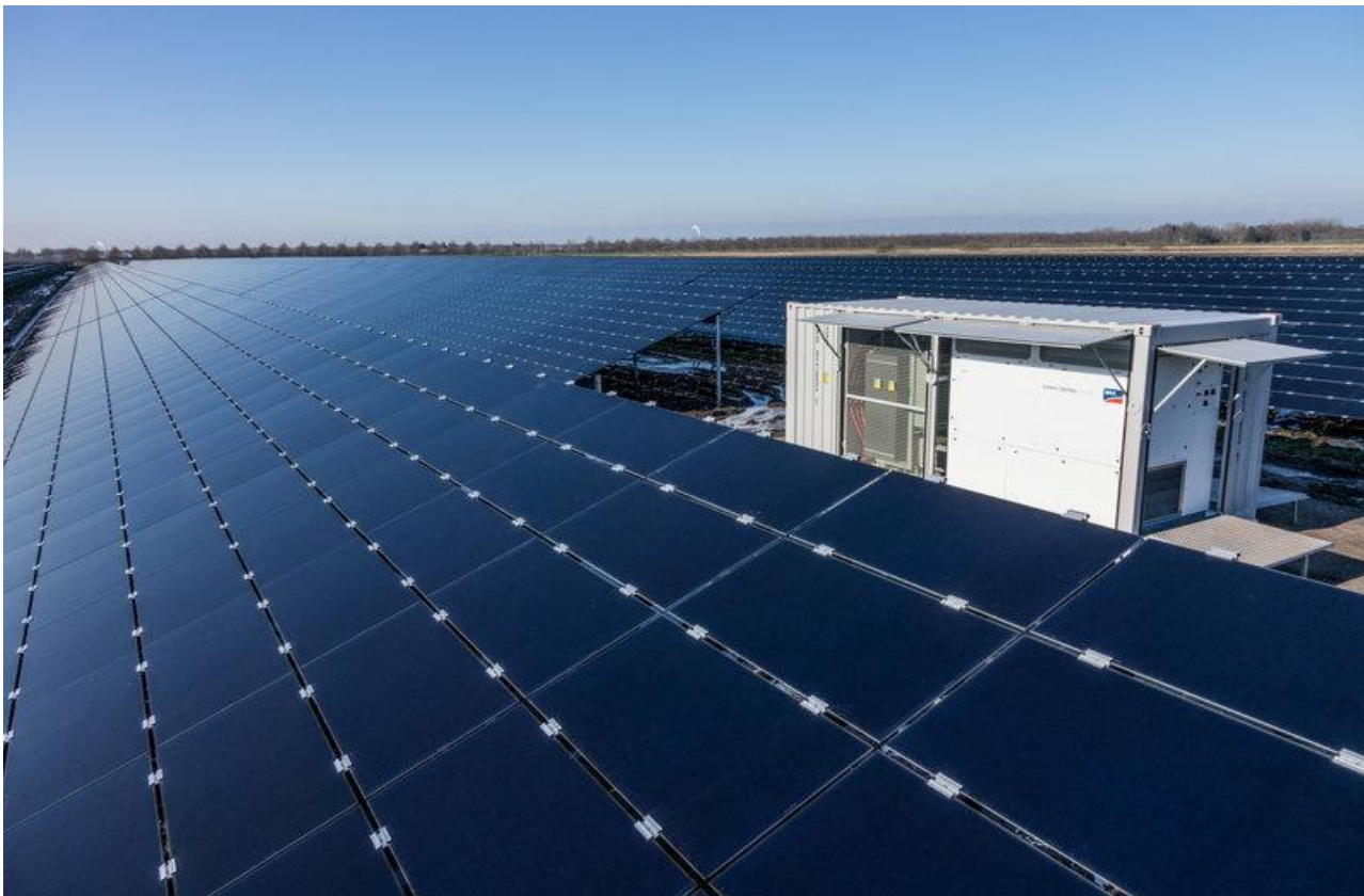
Fot. 6. Kontenerowa stacja wraz z automatyką (źródło: www.belectric.com ).
