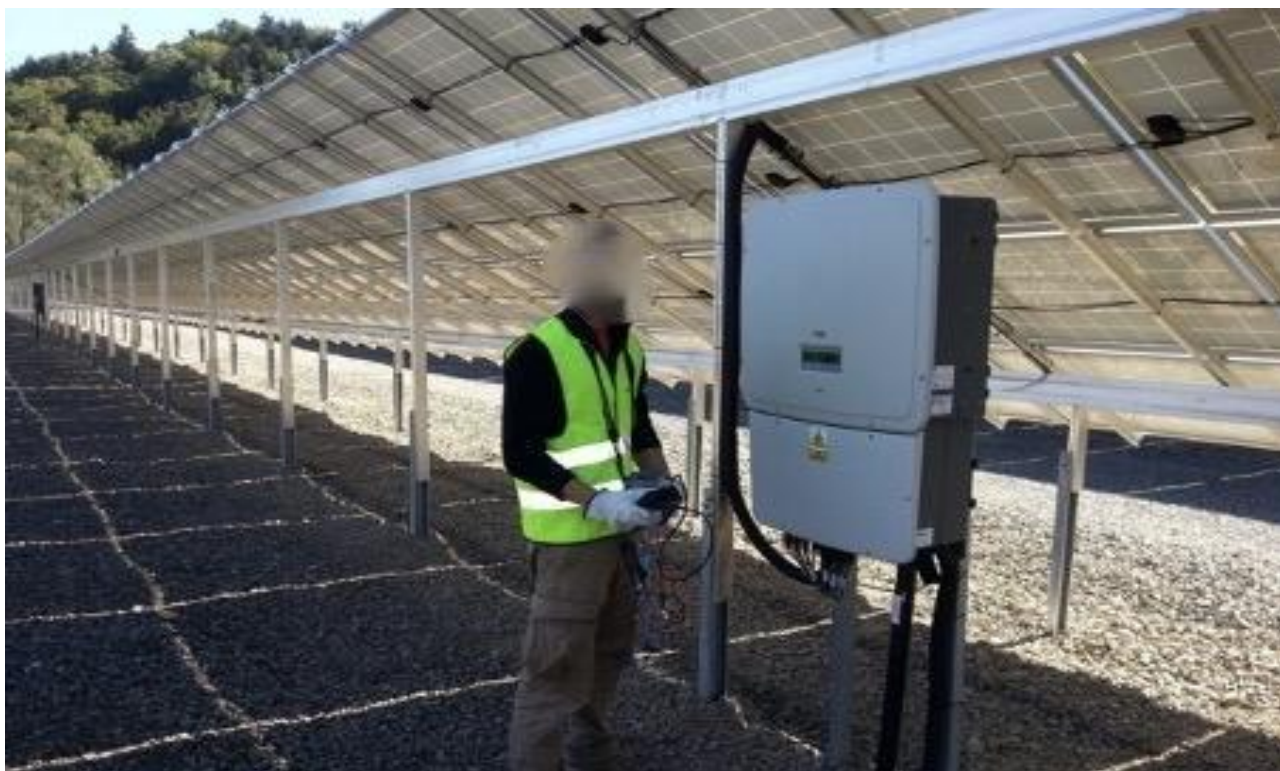
Fot. 5. Instalacja zamontowana pod konstrukcją paneli na pracującej farmie fotowoltaicznej (źródło: www.solgen.pl ).
