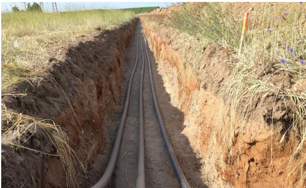
Fot. 4. Rów kablowy z ułożonymi przewodami (źródło: www.eletromontazwschód.pl ).
